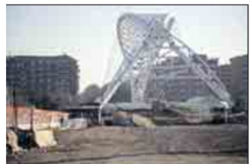
Quasi pronto il nuovo ponte ferroviario che collegherà la Circonvallazione Ostiense a via Ostiense
