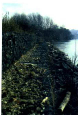
Manufatti idraulici di scarico sulle sponde del Tevere (Prati della Chiavichetta)
