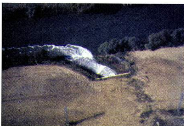
Manufatto di scarico nel Tevere del Depuratore Roma Sud
