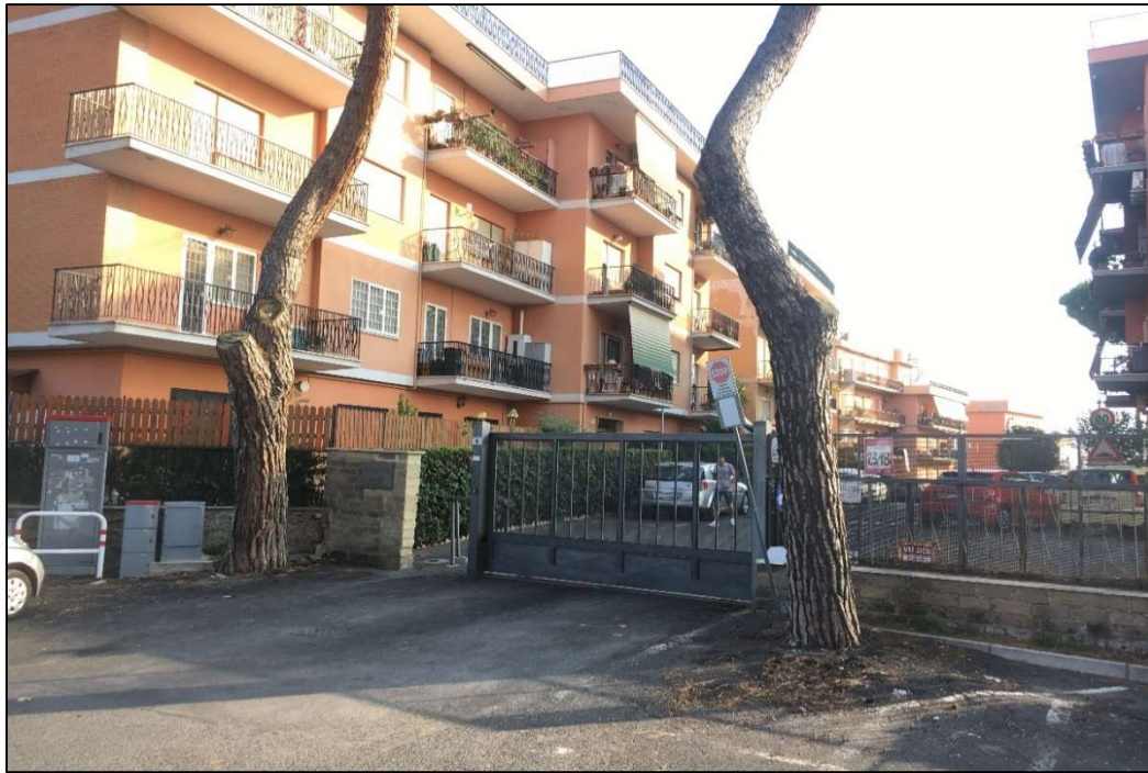
Contesto condominiale: gli alberi crescono con difficoltà per assenza di suolo scoperto e causano danni alle strutture (asfalto, muri, cancello, tubature del gas)
