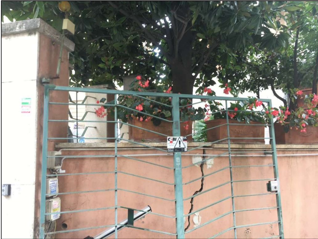
Muro di cinta fratturato da una magnolia
