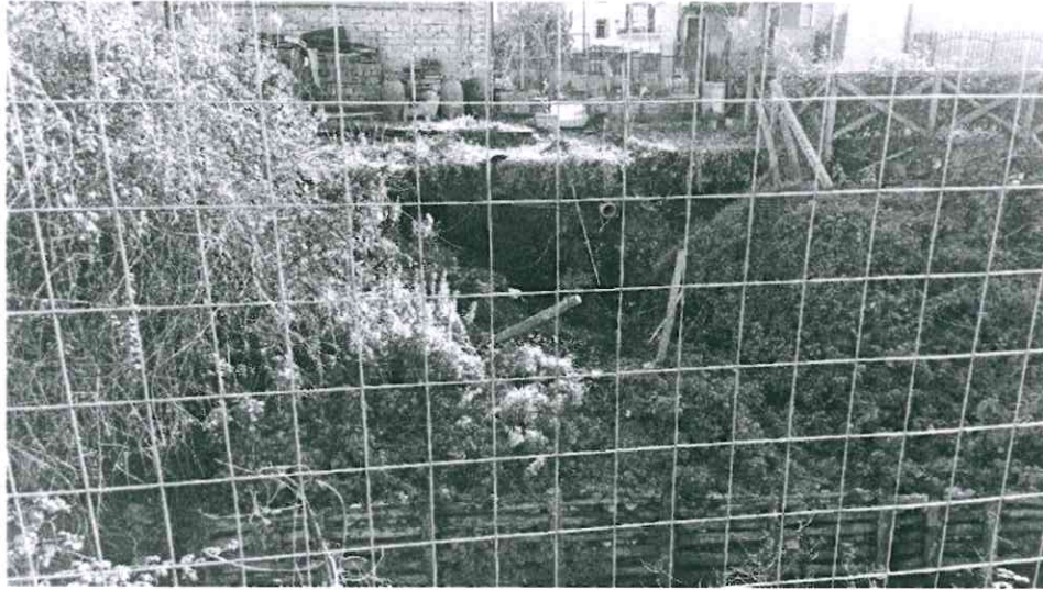
Foto 3 – Tratto 3 - tratto di sponda franata per colamento
